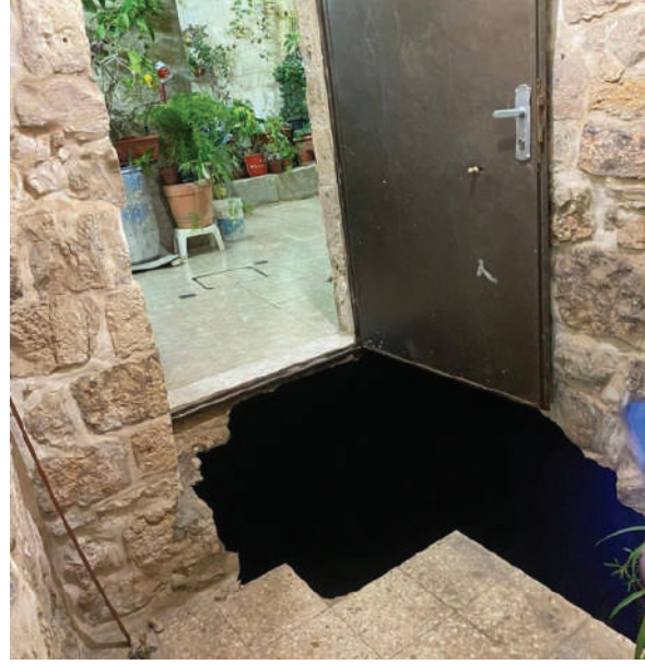
انهيار أرضية منزل من عائلة الشرباتي بالبلدة القديمة
